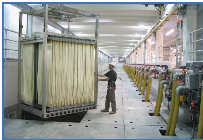
Мембранные модули собираются в кассеты, которые помещаются в резервуары / аэротенки.
